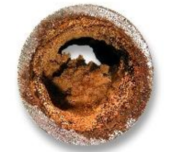
Verkalkte Rohrleitung aus einem Schweinebestand
