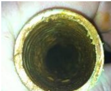
Mangan-Eisenablagerung in Rindertränkleitung
